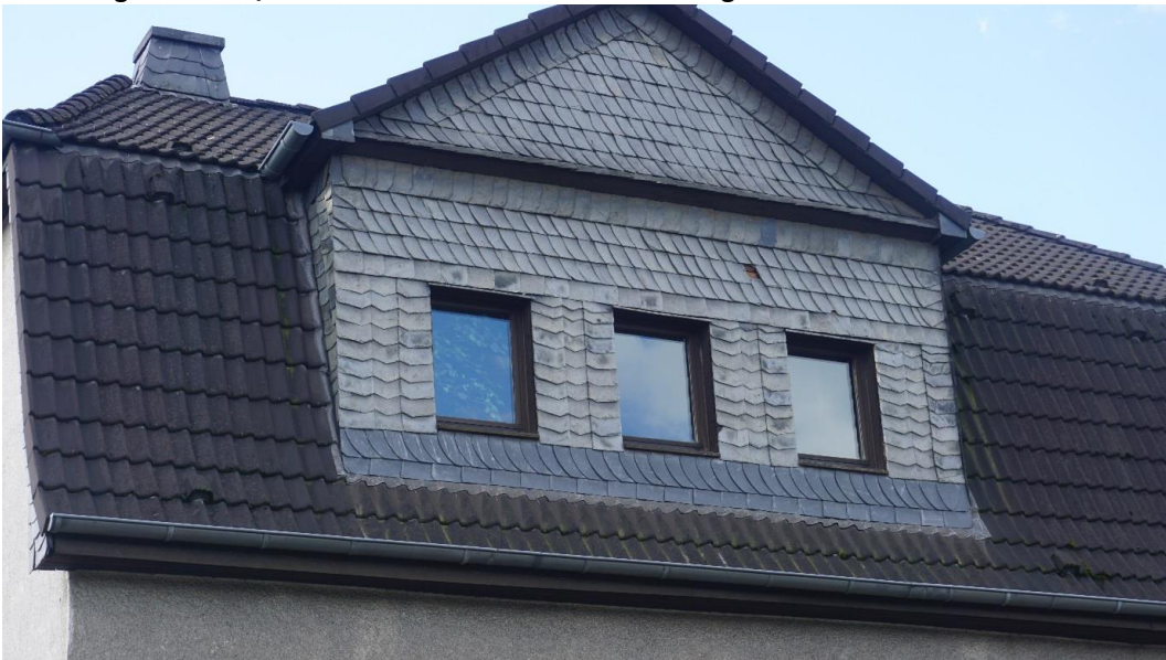
Abbildung 10: Dachgaube mit defektem Schiefer
