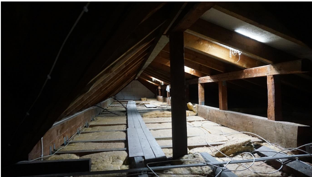
Abbildung 4: Dachboden mit Spalten im Firstbalken
