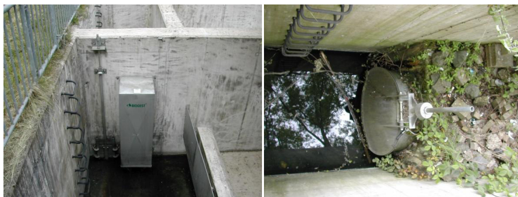
Abb.: RKB Nord Alpheus-Abflußbegrenzer u. Einleitungsbauwerk mit Rückschlagklappe
