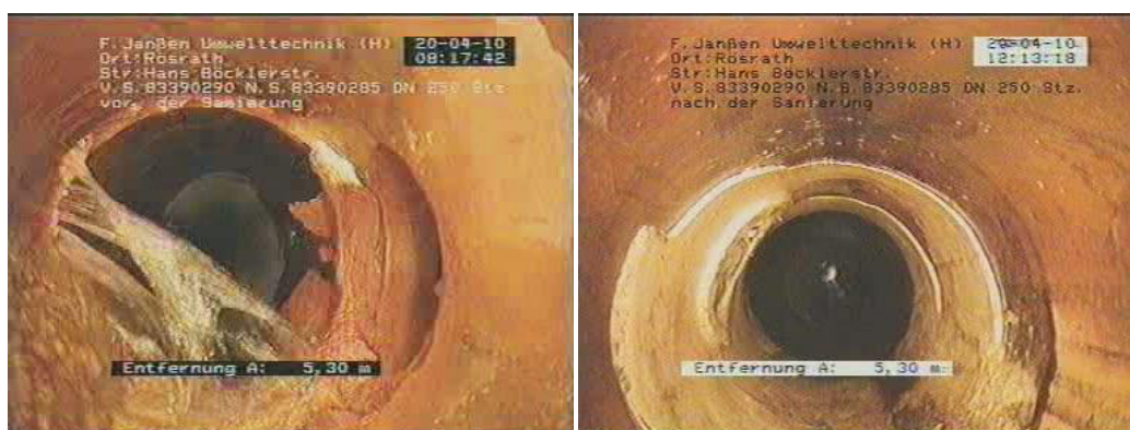
Abb.: SW-Kanal mit starkem Grundwassereintritt vor und nach erfolgreicher Sanierung (Schmutzwasserkanal im Gewerbegebiet Scharrenbroich)
