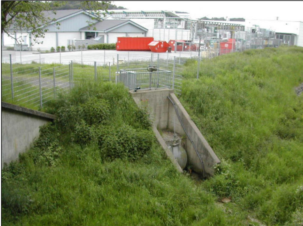
Abb.: RKB- Scharrenbroich Süd: Einleitungsbauwerk mit Rückschlagklappe und Hochwasserschütz
